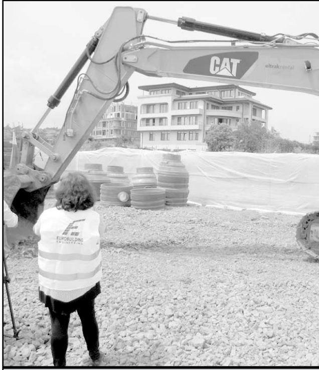
Изграждането на ВиК мрежата на кв. „Мисаря“ ще приключи в края на тази година,заяви по време на ритуала по първа копка кметът Панайот Рейзи
